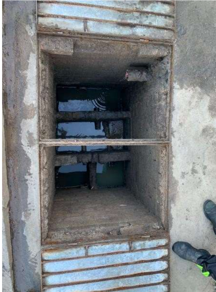
Figura 07 – Caixa Separadora de Água e Óleo
